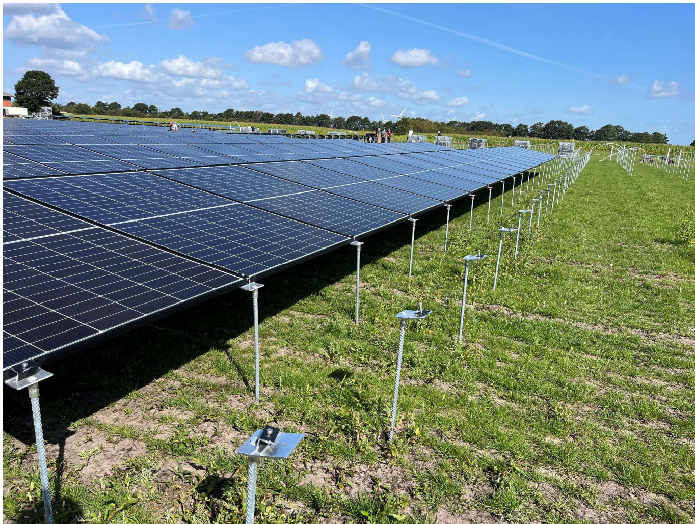
Selvbærende kvalitetspaneler fra Trina Solar, 450 W, monteres på alutopppe i ”øst – vest-opstilling” i store sammenhengende felter
